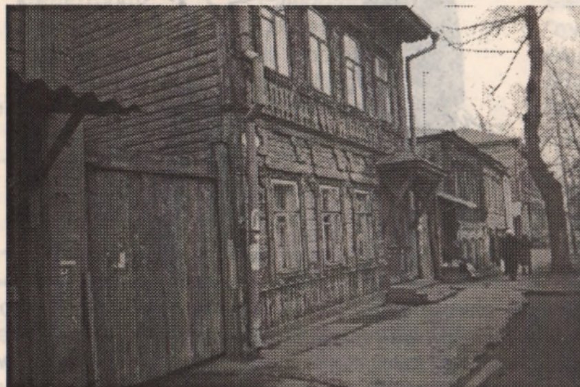
Samara, gevel van huis in typische plaatselijke bouwstijl. Veel huizen hebben te lijden onder verwaarlozing of juist gebrek aan mogelijkheden om ze goed te onderhouden.
